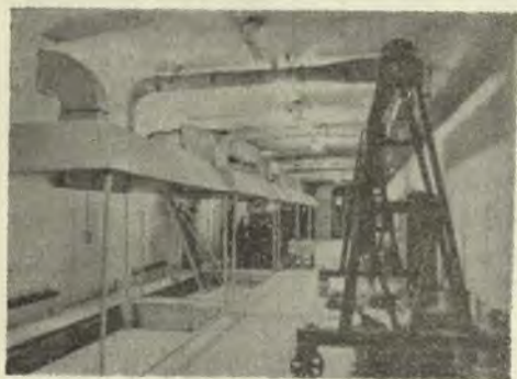
Equipo de una central subterránea
